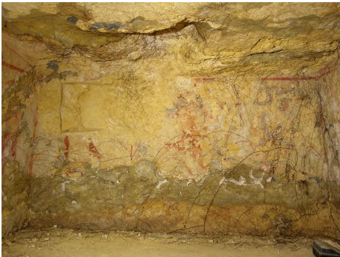
Figura 6 - parete sinistra prima del pronto intervento di consolidamento e rimozione delle radici
