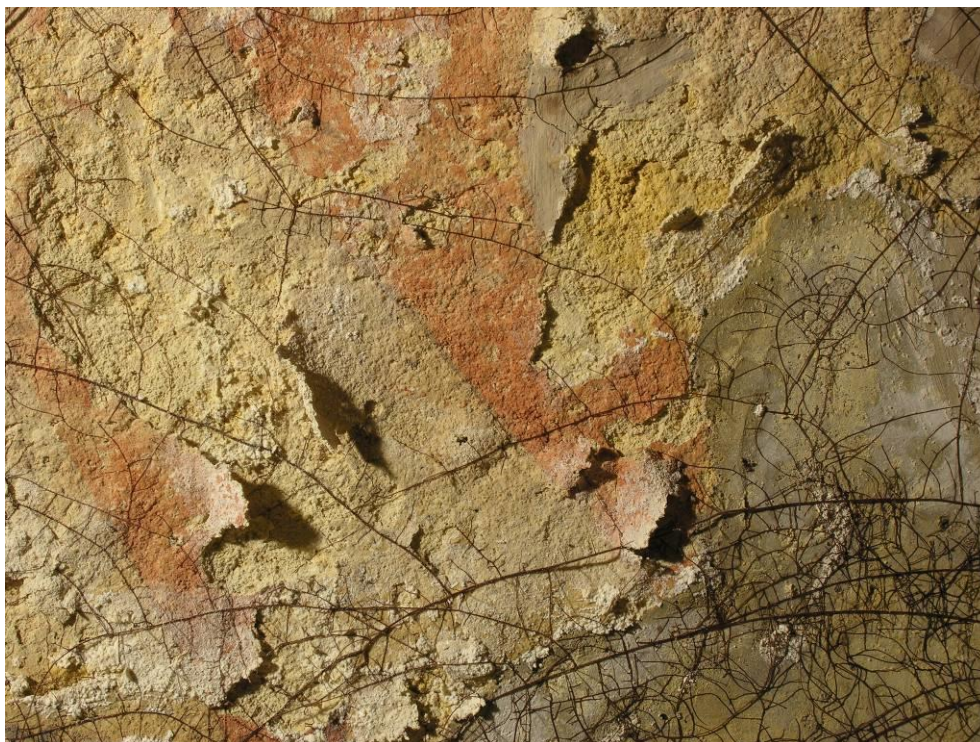
Figura 10 - Particolare della parete sinistra -le scaglie dure e vetrose sollevate e deformate-
